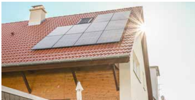
Ab 1. Februar 2024 erhalte neu in Betrieb gegangene PV-Anlagen eine etwas geringere Einspeisevergütung. Foto: Gülay Keskin
